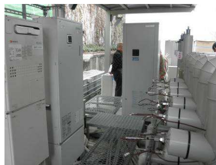
ハウスの裏に置かれた多くの設備
