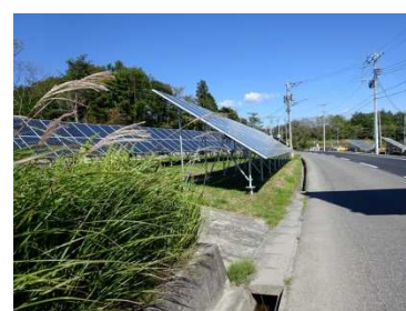
道路沿いに柵も無く設置されている太陽光発電
